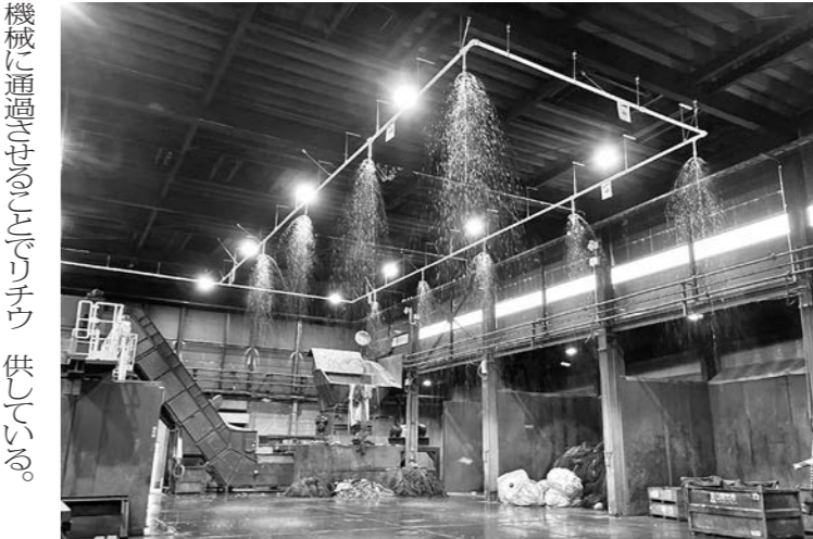
地元の設備会社と「チェッカー式スプリンクラー」を共同開発。小さな発火からセンサーで自動感知して適切な場所に放水して消火する(加山興業)
