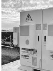
新設した蓄電池
