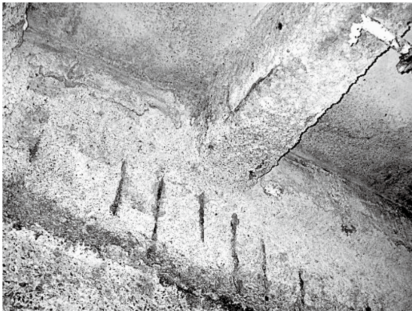
写真2 返流水槽（鉄筋露出・防食はがれ）
