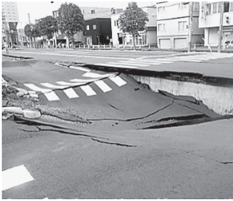
写真2 被災状況 (東区15丁目屯田通)
