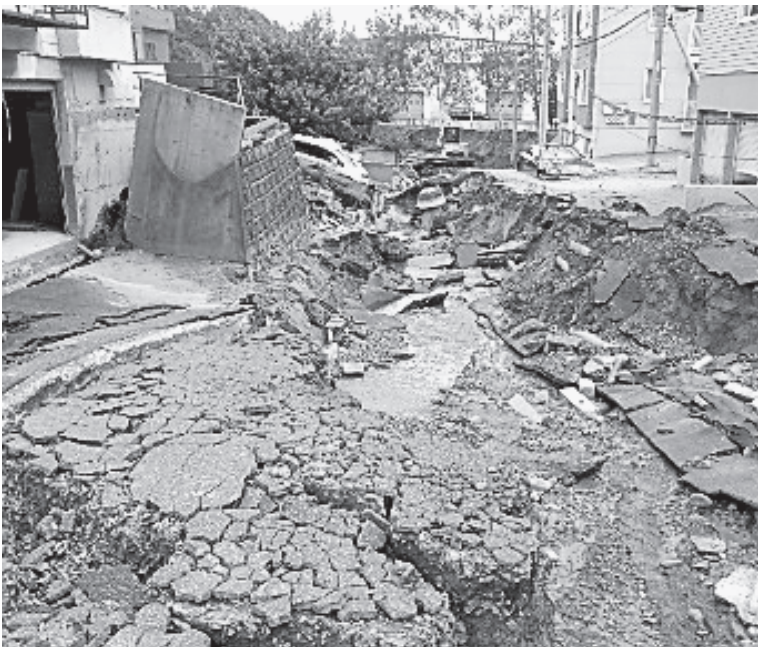
写真1 被災状況 (清田区里塚地区)
